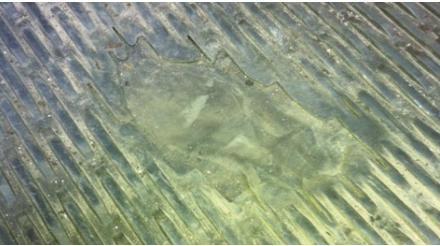
Fodbrønde skal være uden skader og må ikke være smurt ind i skidt, olie eller fedt.
